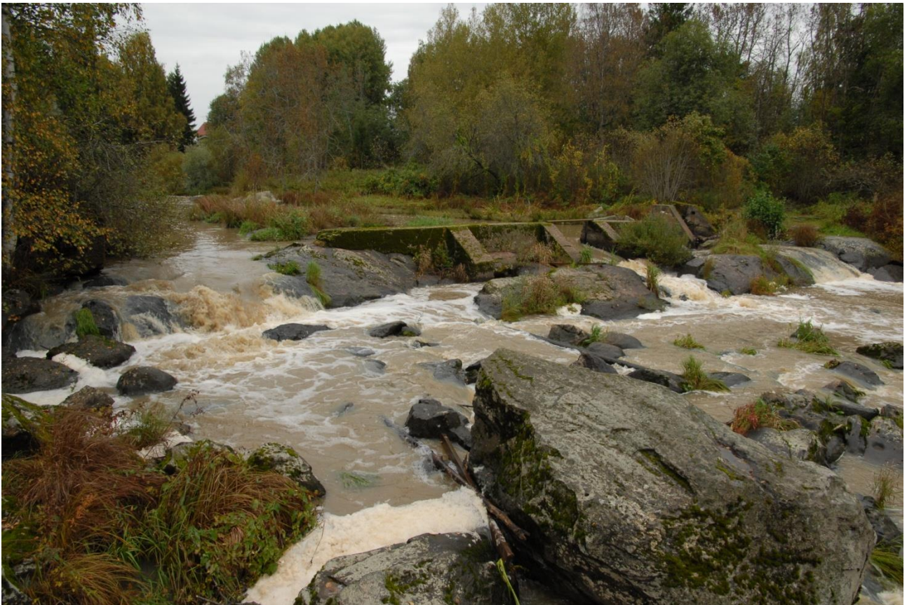
Kuva 80. Patakosken padon rakenne on osittain hajonnut eikä muodosta kaloille varsinaista vaellusestettä.
